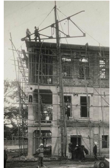
Hình 2. 12 Quá trình thi công hệ vì kèo mái một công trình TDP
