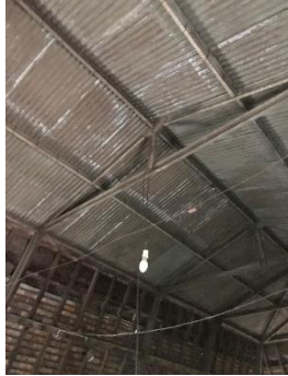
Vì kèo thép hình đỡ mái Nhà khách chính phủ
