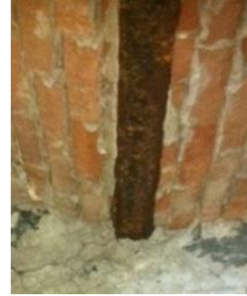
Chi tiết dầm thép móng bị ăn mòn Vaxuco
