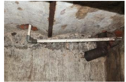
Hình 2. 36 Hiện tượng xả thải trực tiếp xuống tầng hầm các công trình KTTĐP
